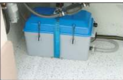
▲ Gassicher untergebracht, die Batterie.
